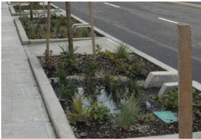
Des bassins de rétention des eaux de pluie sur le trottoir, Portland, OR. Source : PERMA
